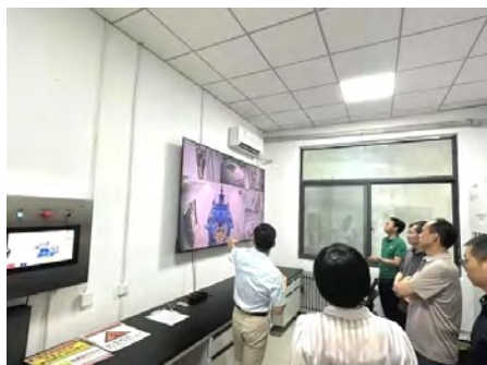
离心机监控及控制室
